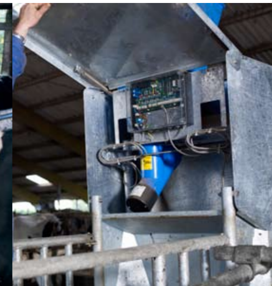
Toutes les parties du système d'alimentation programmée sont facilement accessibles
